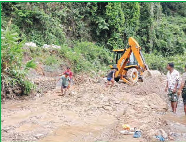
माई न.पा. वडा नं. ३ र ९ को मुसेखोला र माईखोलामा ग्याबिन तटबन्धन व्यवस्थापन कार्य
