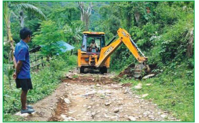
माई न.पा. वडा नं. १ र ३ जोड्ने, लोदिया खोलाको फुटपात क्रसिङ्ग पुलको निर्माण कार्य सम्पन्न गरेको
